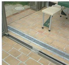
ガーデンルームの排水設備
